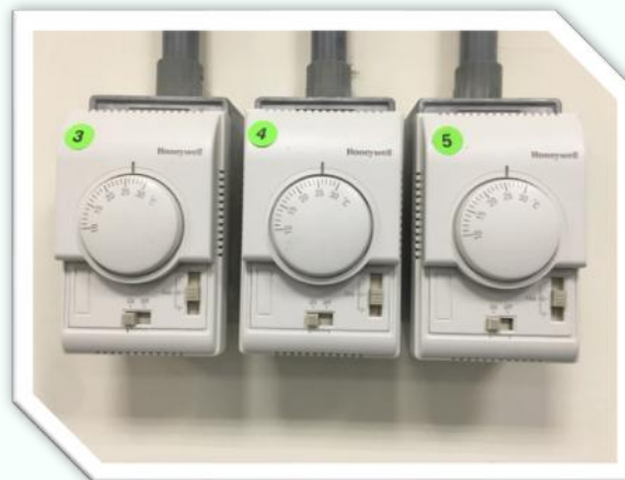
空調採用恆溫裝置
